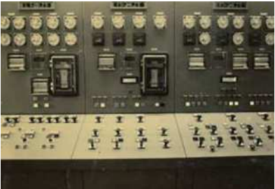
・三宅浄水場操作盤
