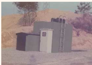
第3 加圧ポンプ
