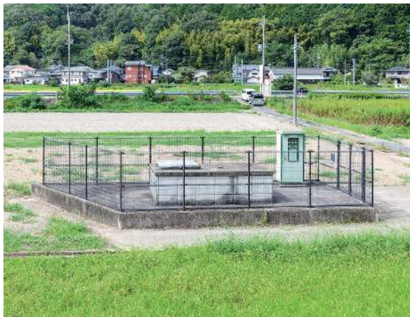
・千代川浄水場系8号取水井戸
