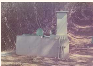
第2 加圧ポンプ
