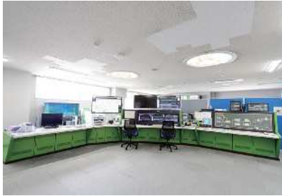
・千代川浄水場集中管理室
