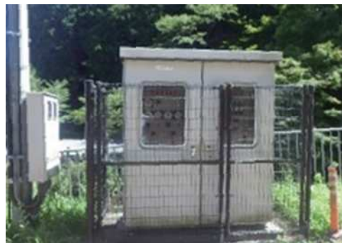
・北ノ庄加圧ポンプ場
