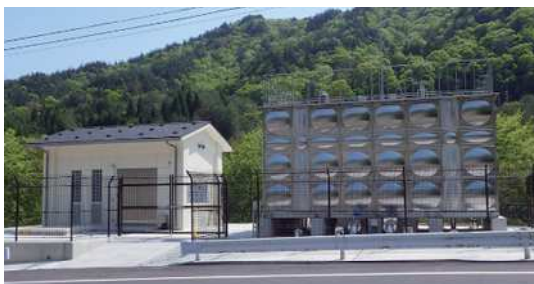
・高橋配水池 土ヶ畑第1加圧ポンプ場
