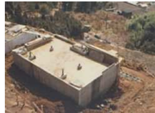
・増設配水池（昭和54（1979）年）
