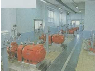
・三宅浄水場送水ポンプ室
