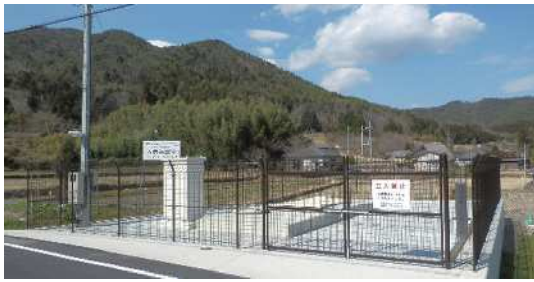
・西加舎第1加圧ポンプ場（本梅町）
