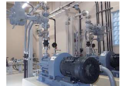
・西山加圧ポンプ場
