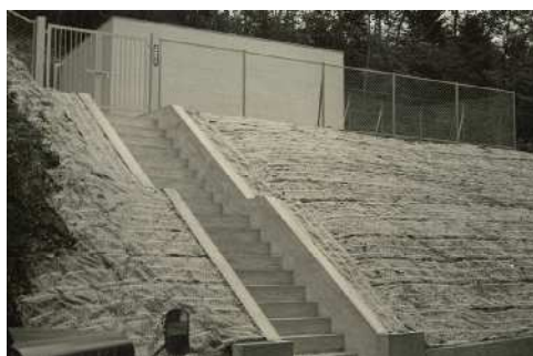
・創設時の犬甘野配水池（現在も使用）
