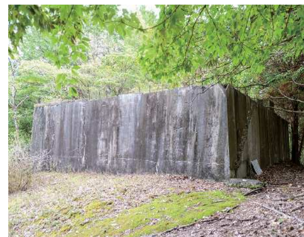
・旧西山配水池
