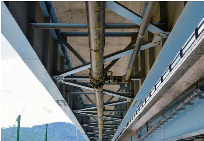
・月読橋連絡管（現在は送水管）
