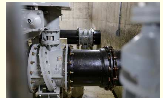
・平和台配水池緊急遮断弁
