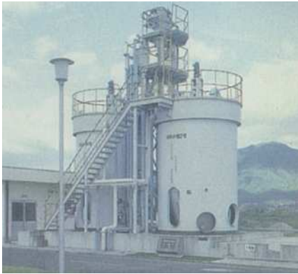
・千代川浄水場 消石灰自動注入設備
