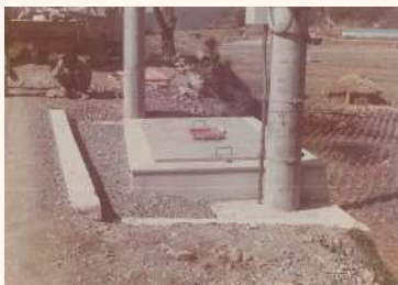
第1 加圧ポンプ
