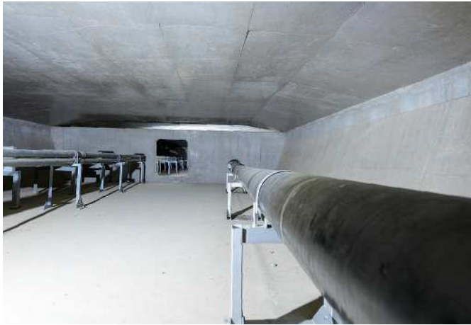
・保津橋送水管
