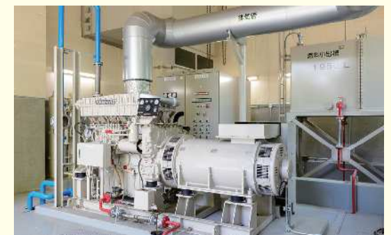
・千代川浄水場非常用発電機
