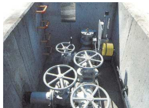
・緊急遮断弁（旭配水池に設置）
