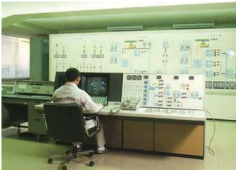
・春日坂管理本館中央監視室
