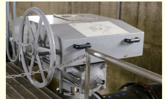
・平和台配水池緊急遮断弁
