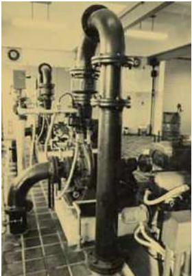
・三宅浄水場送水ポンプ
