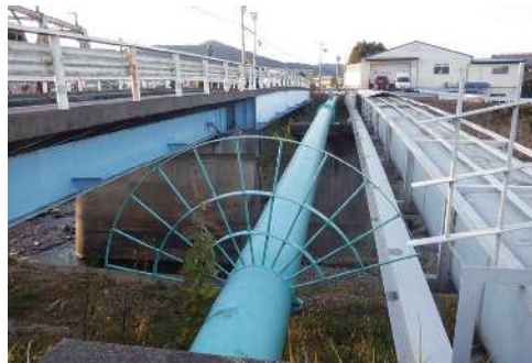
・犬飼川横断水管橋 湯井配水池系統配水幹線（φ450mm）
