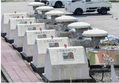
・千代川浄水場送水ポンプ（水中ポンプ）
