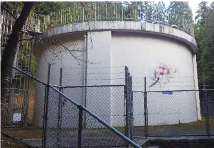
・曾我部簡易水道・寺配水池
