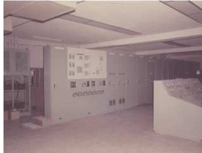
・千代川浄水場監視室
