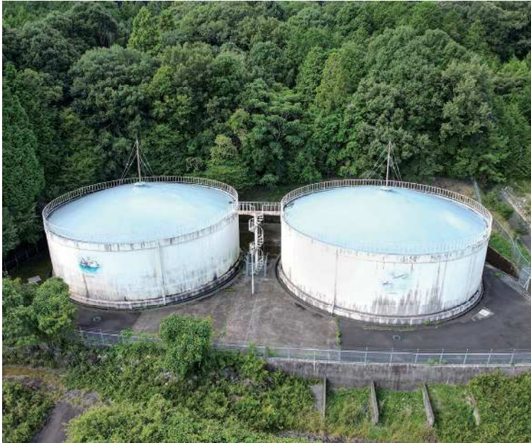
・湯井配水池（1号・2号）
