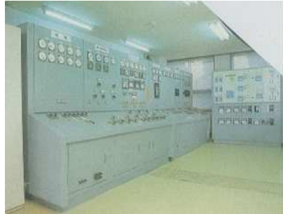
・三宅浄水場監視室
