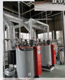
高効率ボイラーの導入
