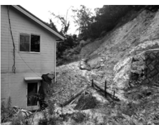
7月豪雨によって被災した民家
