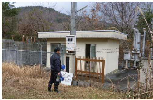
補助金制度を創設！(東別院町内の共同取水施設)
