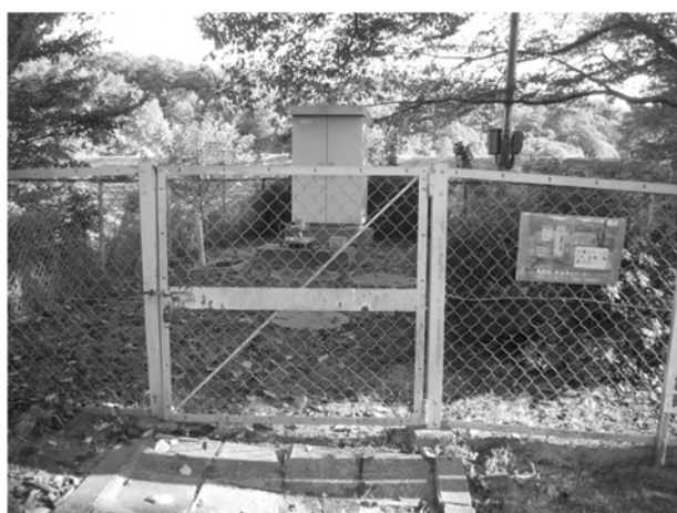
●西つつじヶ丘汚水中継ポンプ場
