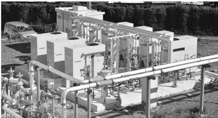
《消化ガス発電システム》
