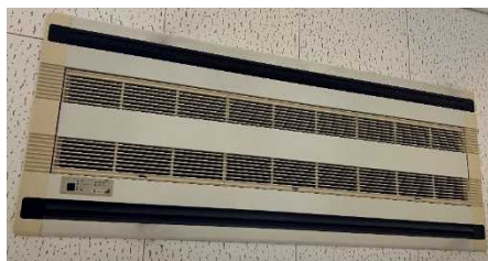
空調機：平成8年8月26日施工
