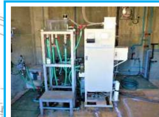
全窒素・全りん測定器 (R5~R6) 経過年数:H7(28年経過) 概要:放流水の窒素・りんを測定 能力:24時間測定
