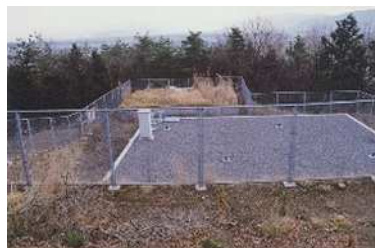
・旧馬路配水池（昭和63年拡張時）
