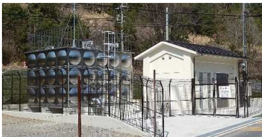
・西加舎第2加圧ポンプ場（本梅町）
