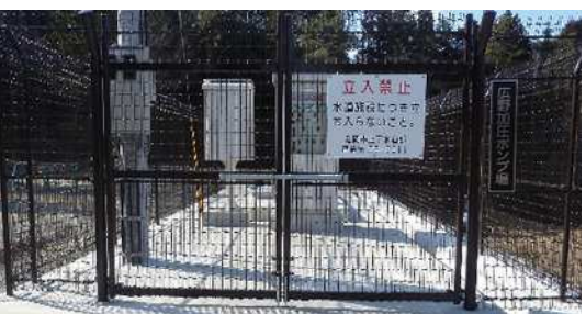
・広野加圧ポンプ場
