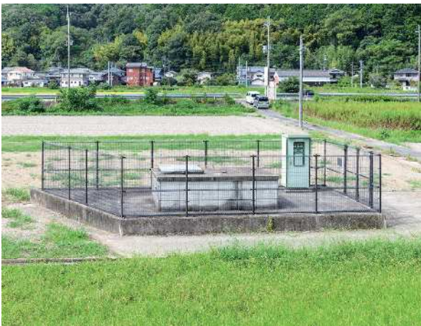
・千代川浄水場系8号取水井戸
