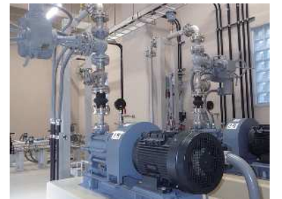
・西山加圧ポンプ場
