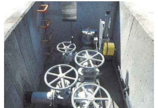
・緊急遮断弁（旭配水池に設置）
