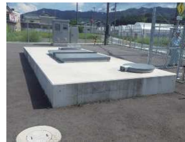
・王子加圧ポンプ場
