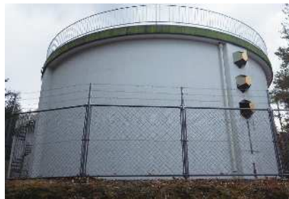
・湯の花配水池
