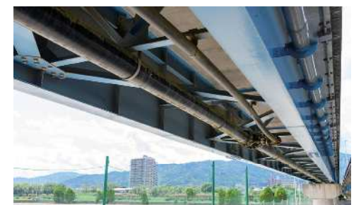
・月読橋下部φ200mm配水管
