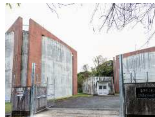
・南つつじヶ丘第2配水池
