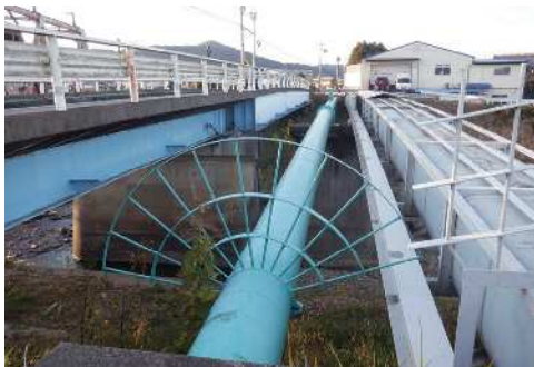
・犬飼川横断水管橋 湯井配水池系統配水幹線（φ450mm）
