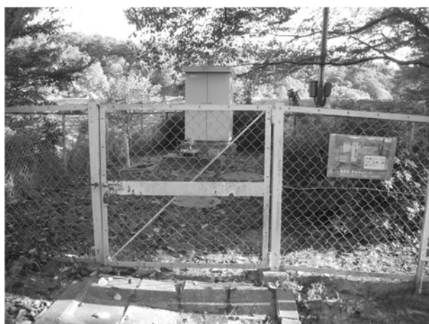
●西つつじヶ丘汚水中継ポンプ場
