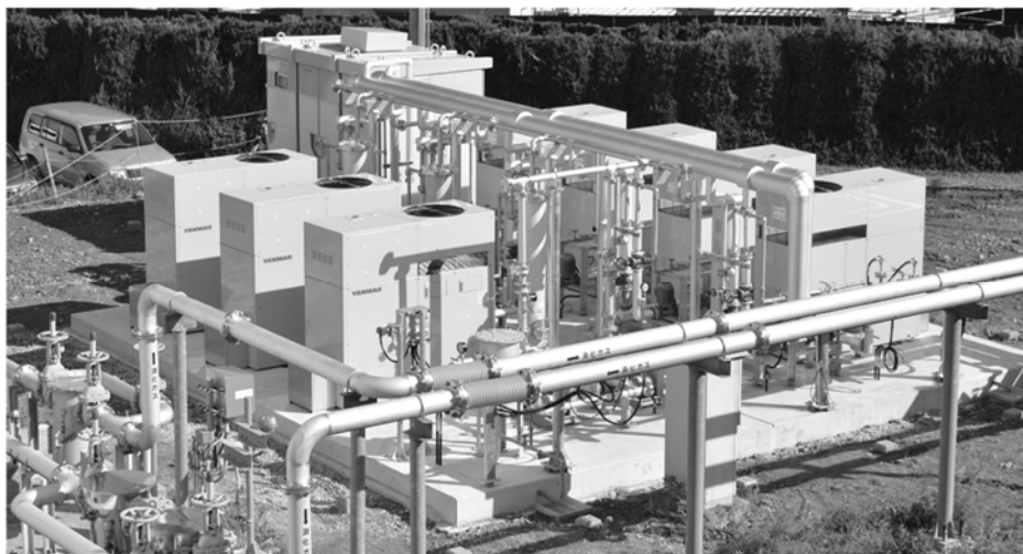
《消化ガス発電システム》
