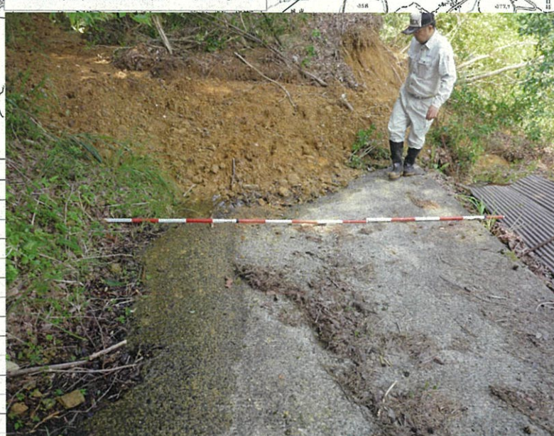
山崩壊農道封鎖 畑野町
