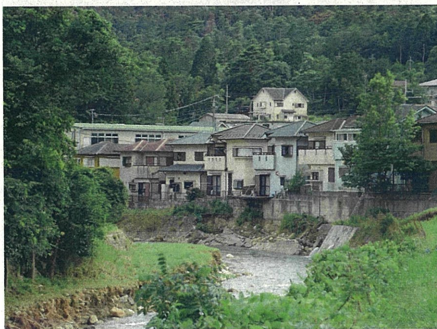
大路次川の護岸損傷（畑野町）
