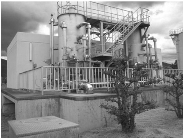
● 用水棟 場内で処理した水の一部を砂ろ過して、ポンプ等の 冷却や汚泥脱水に使用する薬品の溶解に利用しま す。
