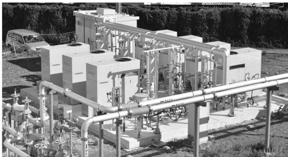
《消化ガス発電システム》
