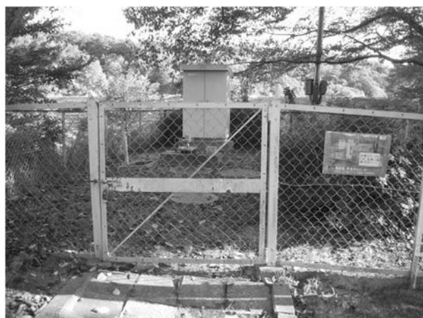
● 西つつじヶ丘汚水中継ポンプ場
