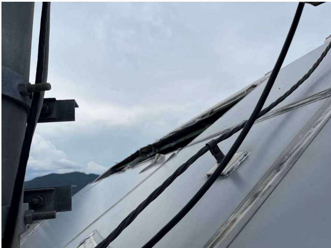
屋根点検口より破損箇所確認
