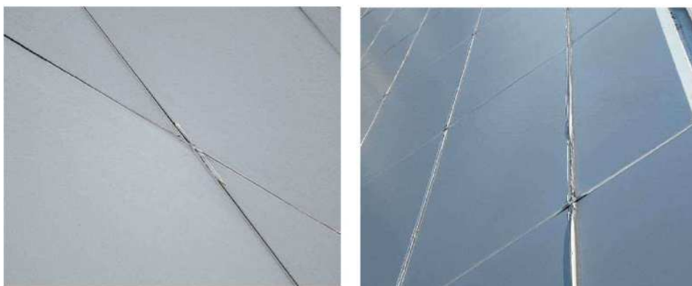
屋根 (1) (2) アルミパネルジョイントシールの劣化、破断から漏水につながると推測される
