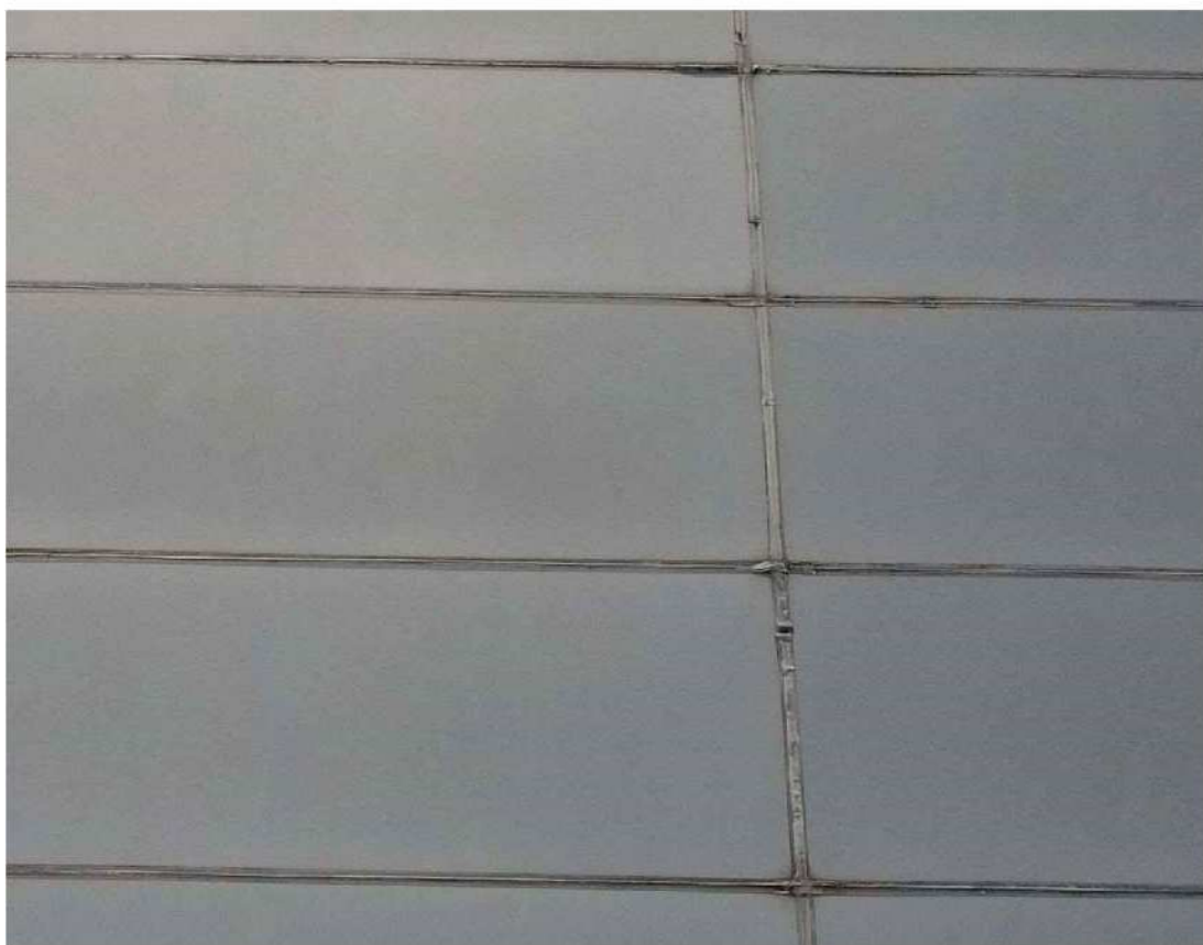
ジョイントシール劣化状況
