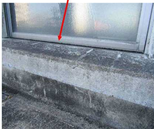
アゴ面台浮き、ひび割れ
