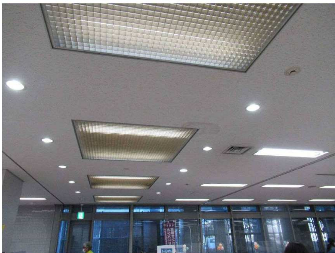
天井漏水状況
