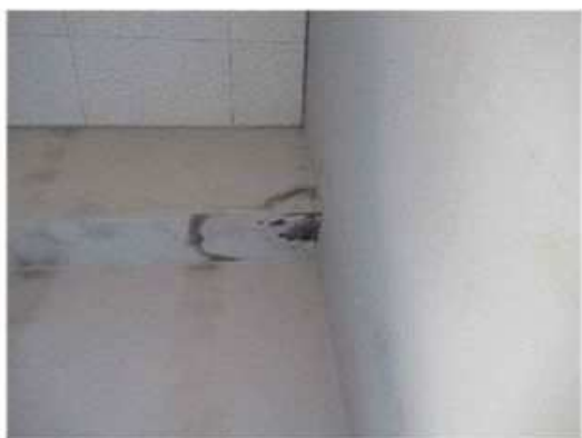
屋根(2)より内部階段へ漏水が確認される
