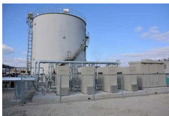
亀岡市年谷浄化センター
