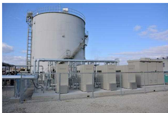
亀岡市年谷浄化センター
