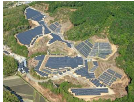
京都・亀岡メガソーラー発電所
