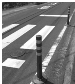
カラー舗装が消えている箇所
