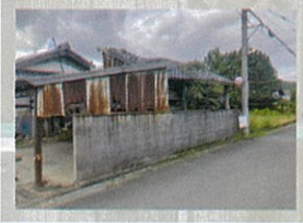
崩れそうな古いブロック
