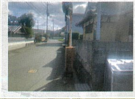
崩れそうな古いブロック
