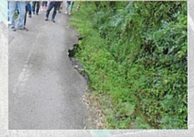
下川河川一部決壊(修復)
