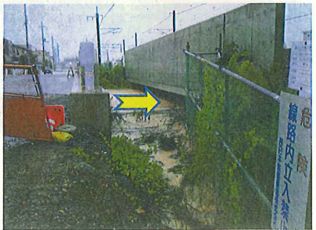
台風18号 状況写真 JR嵯峨野線雑水川橋梁 平成25年9月16日 午前6時40分撮影
