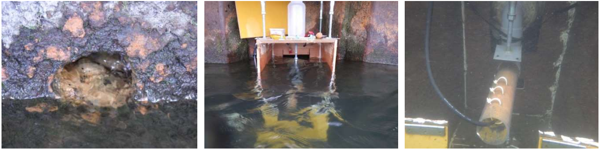
図 1-5-6 湧水観測装置の様子（左：矢板 I 湧水孔、中央：設置した観測装置、右：観測管） （撮影日 左：H29. 11. 20、中央・右：H29. 11. 14 成果品より）
