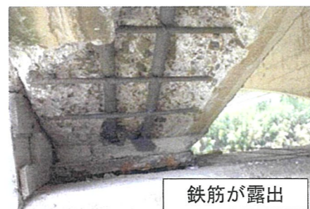
宇津根橋損傷状況
