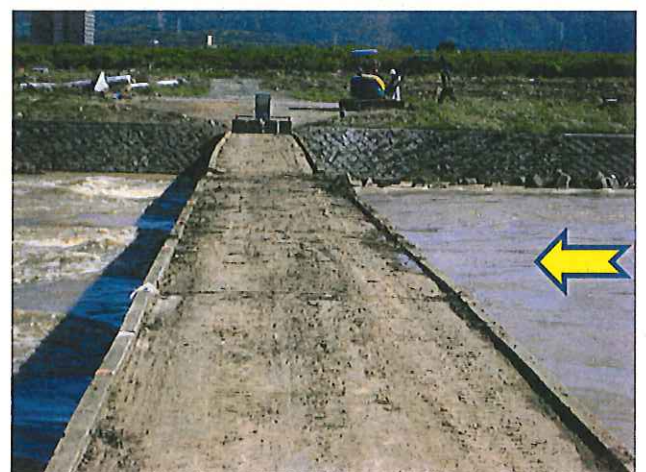
台風18号 被災状況写真 左岸側から保津小橋 平成25年9月20日 午後2時00分撮影
