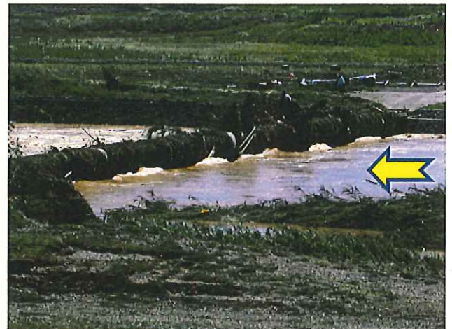
台風18号 状況写真 左岸側から保津小橋 平成25年9月17日 午前11時10分撮影
