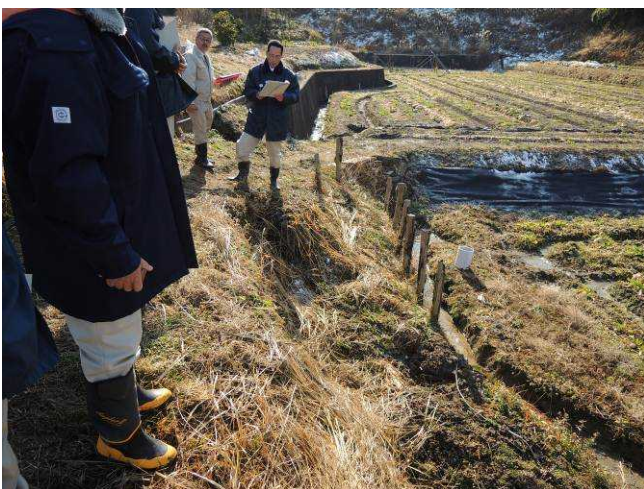
農道崩壊箇所（小災害）※資料（現地3-2）
