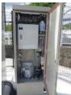
自動水質検査装置（遠隔監視）
