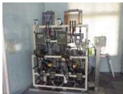
水質測定計器（千代川浄水場）
