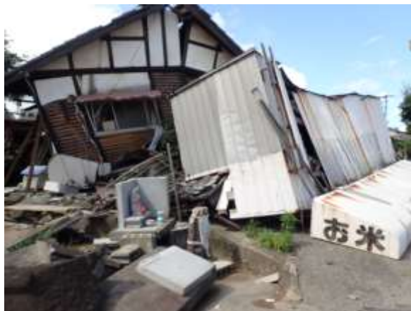
熊本地震被災状況
