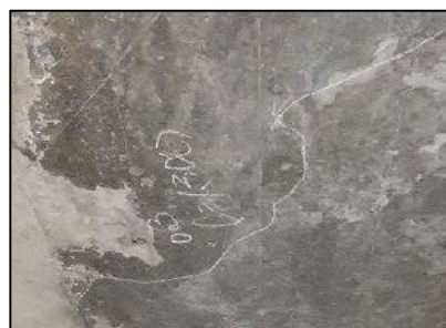
■ コンクリートのひびわれ
