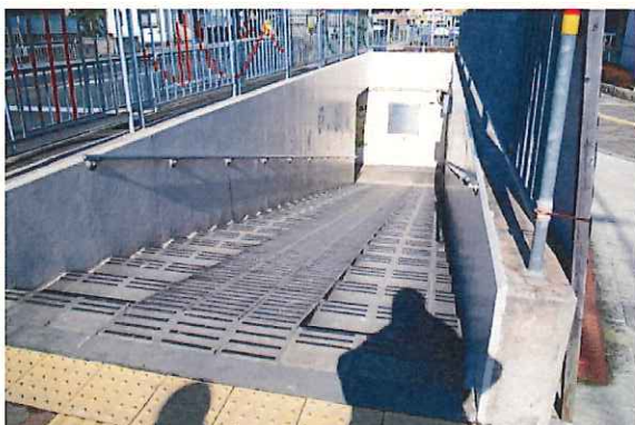
④ 手すり始点が階段途中からとなっている
