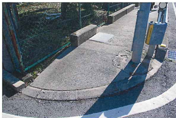
⑦ 歩道幅員が狭く、傾斜あり
