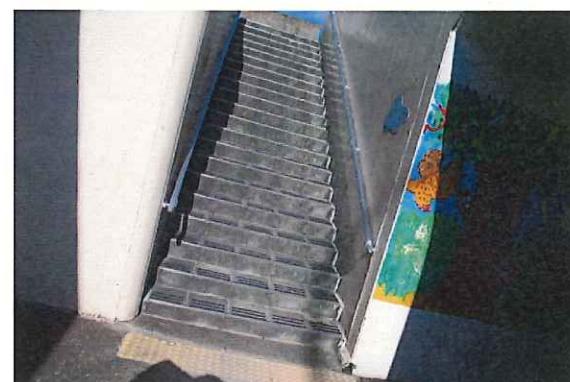
⑥ 北側階段、南側階段以上に勾配が急
