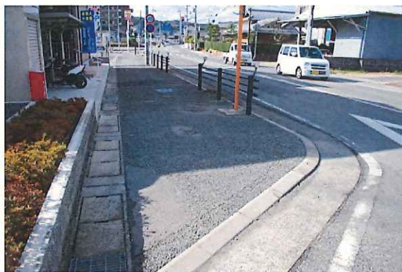
① 舗装劣化
