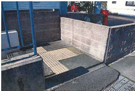
⑦ 北側階段地上部 点字ブロックが障害物方向に誘導
