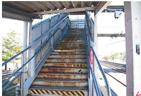
⑧ 手すりあり、手すりに点字誘導あり 跨線橋は老朽化が進む。段鼻部 破損多数(テープ補修)
