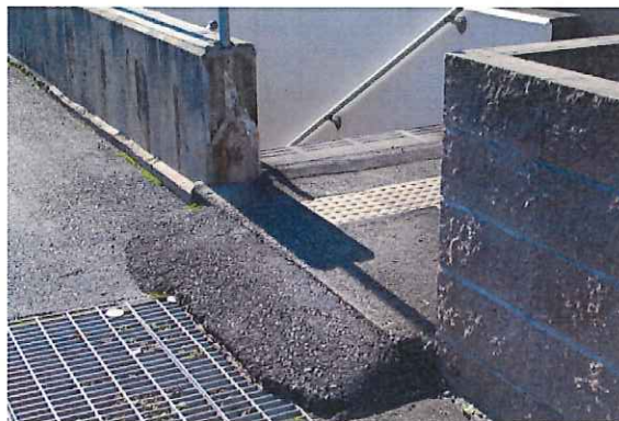
⑧ 歩道との接続部段差
