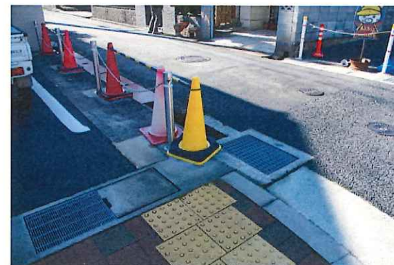
③ 整備道路と細街路の接続部分で 危険箇所あり
