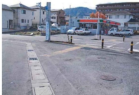
⑤ 府道73号交差点、横断歩道部のみ点字ブロックあり 大型車両出入で舗装劣化
