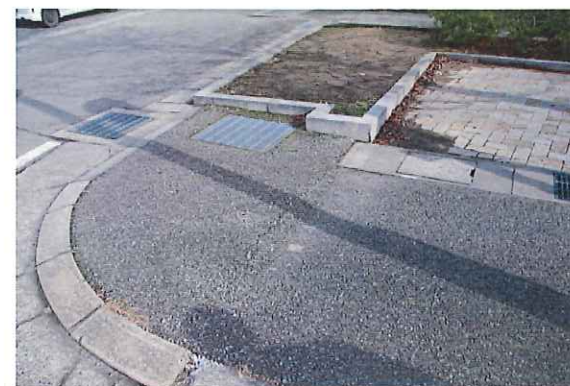
③ ポケットパーク北側、地下構造材の影響による、気づきにくい段差あり
