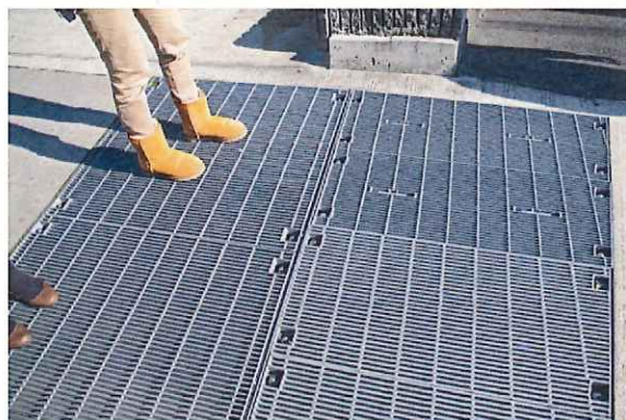
④ グレーチングは適切なものに交換され ているがボルト部分のキャップがない
