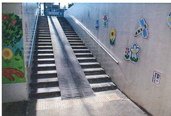
⑤ 急勾配、手すりが階段部のみで点字ブロックとも連続していない
