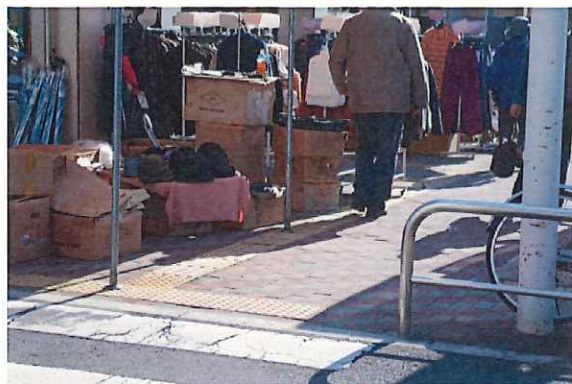
⑩ 店舗出入口付近の点字ブロック 配慮されていない
