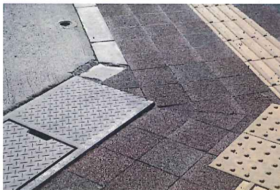
② 沈下により危険な段差が生じている
