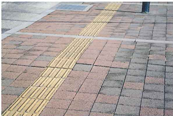
① インターロッキング舗装が乱れている
