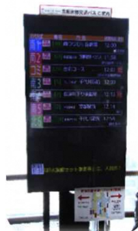
JR亀岡駅 自由通路設置 バスロケーションシステム
