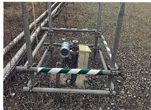
写真 2-3-1 デジタル pH メーター現地設置状況
