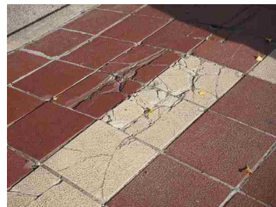
老朽により割れている舗装
