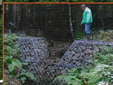
【中野八幡神社横の砂防堰堤】 ・木の枝等で水が堰き止められている。危険！
