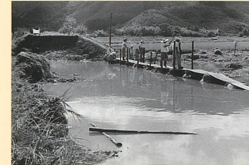
府道が決潰し、陸の孤島となる 応急的な仮設の橋を作成し対応した
