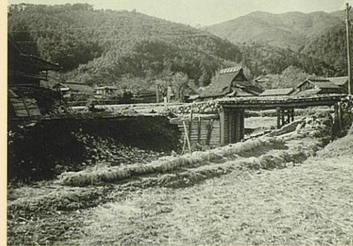
赤坂橋が流出した後の仮橋付近の建物は崩壊した〔撮影 岡本眞治氏〕
